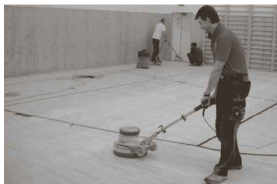
Realizace z regionu - podlaháři při renovaci parket v tělocvičně ZŠ Slovan v Kroměříži.
